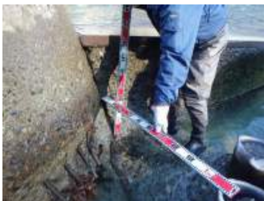
堰柱下部鉄筋露出
