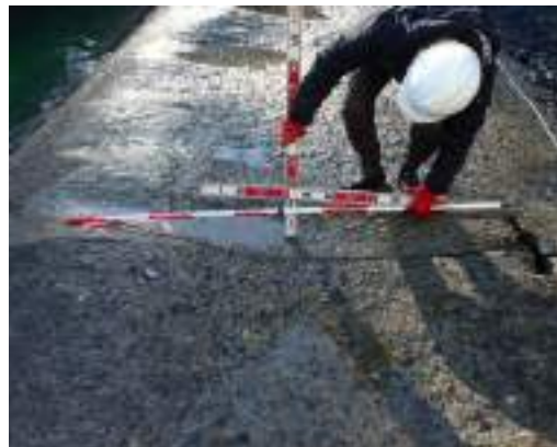
固定堰の摩耗
