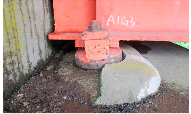
「早期的に措置を講ずべき」15号橋(石坂)の破損部分
