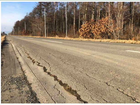
経年劣化により傷んだ町道
