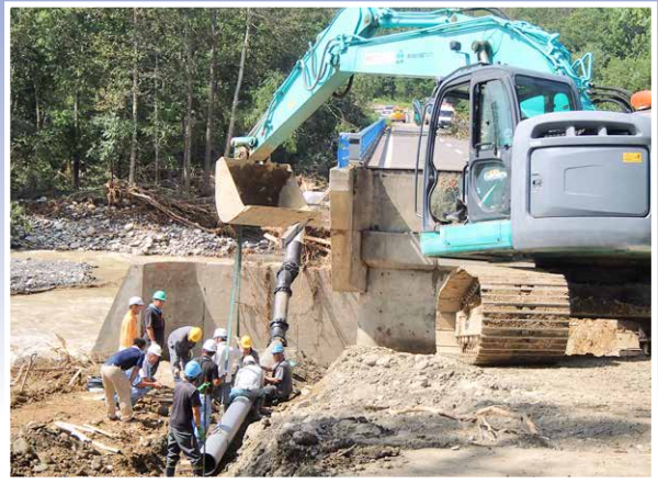
台風被害を受けた管路
