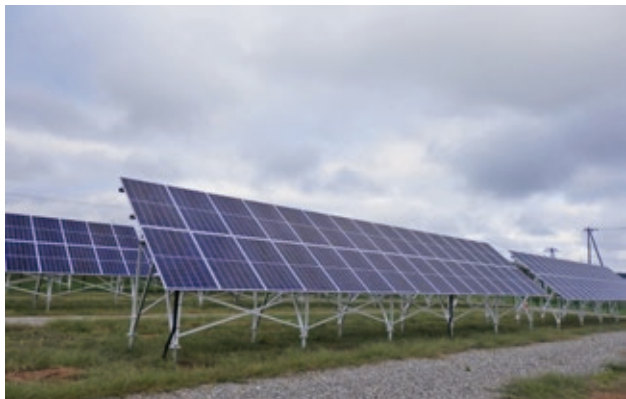
再生可能エネルギー導入施設（太陽光発電所）
